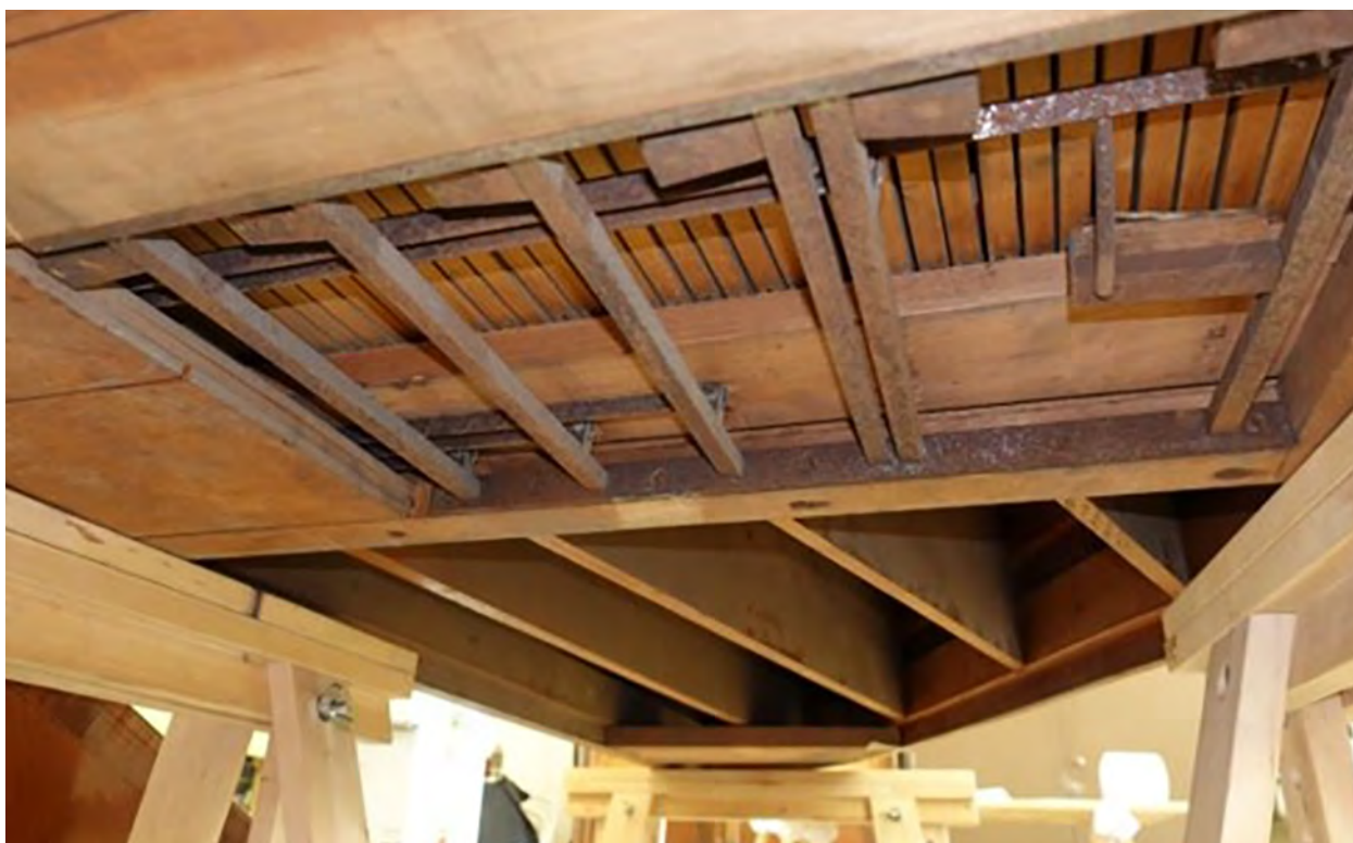
Ukázka kovových součástí poškozených korozí po dlouhodobém vystavení vlhkosti.
